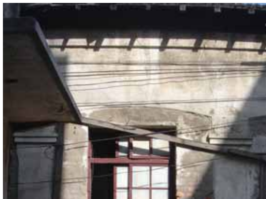
照片 6-8 西向立面第二處磚拱拱與柱接續處裂痕
