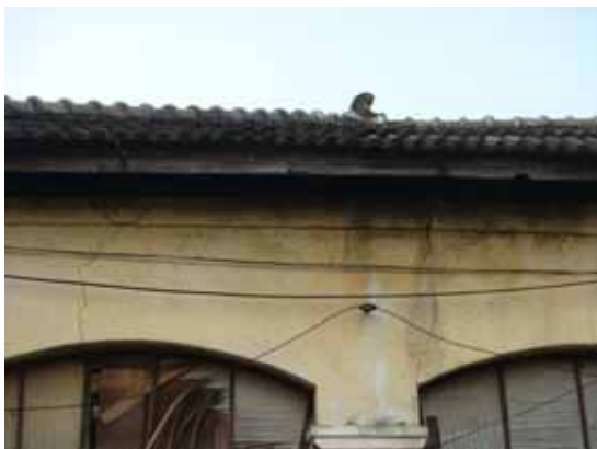
照片 6-7 正立面的磚拱中央裂痕
