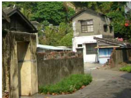
照片 6-36 巡捕區磚造圍牆局部遭敲除
