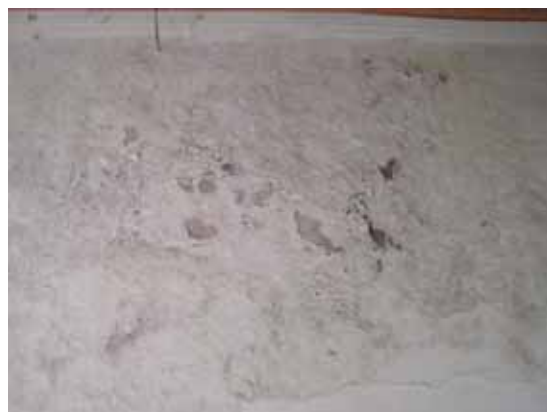
照片 6-14 粉刷層風化剝落損壞
