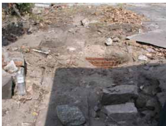
照片 6-1 基礎未出現沉陷、歪斜、龜裂現象
