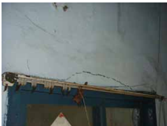
照片 6-13 牆體開裂損壞
