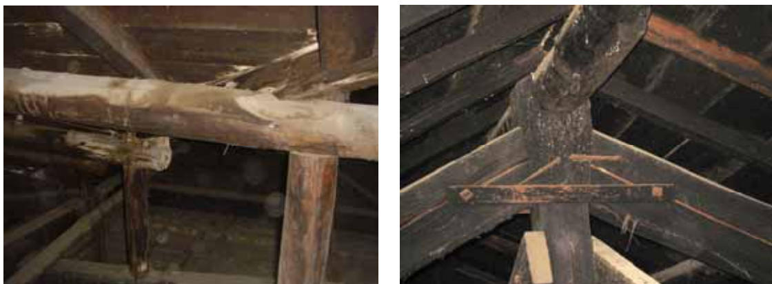
照片 6-26 陸樑、合掌、真束等大木料之乾裂損壞
