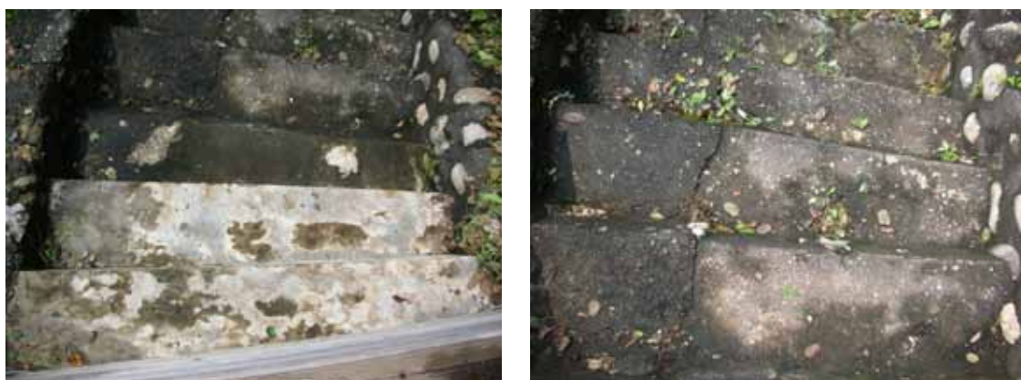
照片 6-39 階梯面因整修而被水泥粉刷層覆蓋
