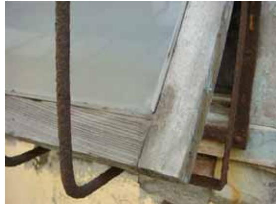
照片 6-19 窗作面漆風化剝落損壞
