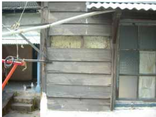
照片 6-12 雨淋板脫落、壁體受潮
