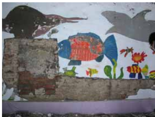
照片 3-26 牆面有一近似保險箱大小之開孔痕跡
