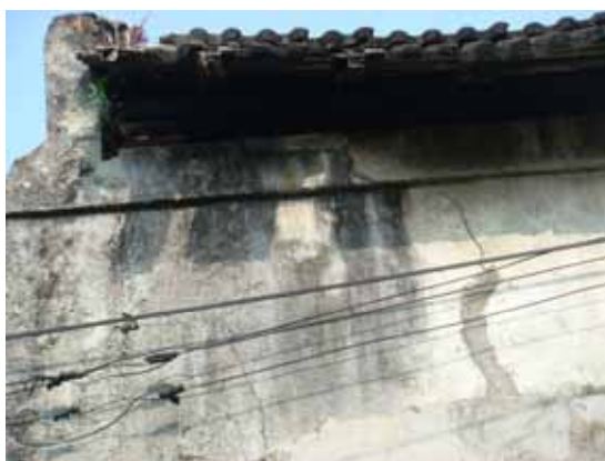
照片 6-9 西向立面第九處磚拱中央裂痕
