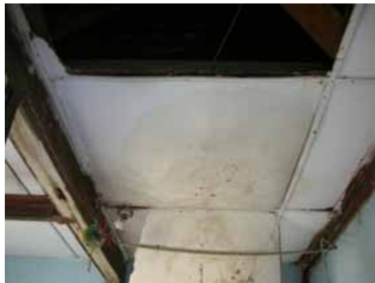
照片 6-25 蔗板天花受潮表面滿佈水漬
