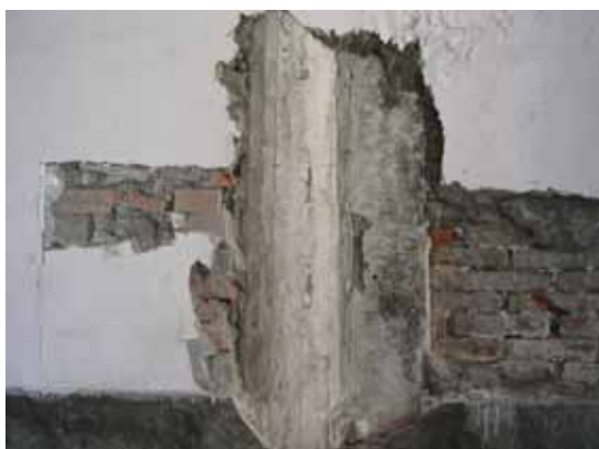
照片 3-22 圓柱左右側磚料、灰縫及磚邊緣工整度均不同
