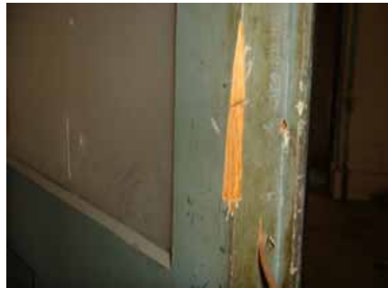
照片 6-16 木料開裂
