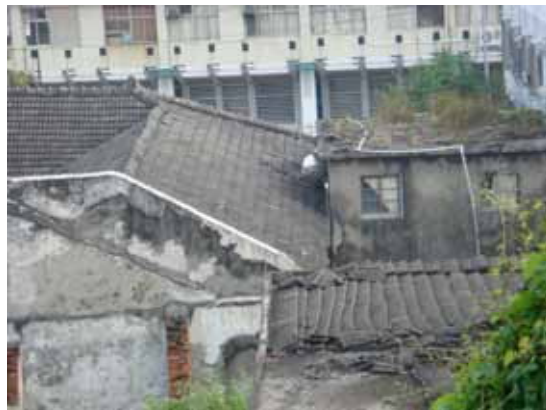
照片 6-31 屋頂掉落水塔撞擊屋面致使屋瓦破損嚴重
