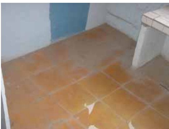
照片 6-5 瓷磚、馬賽克缺角破損損壞
