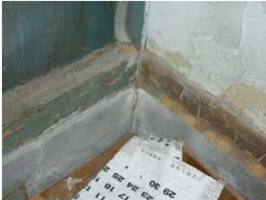
照片 6-18 窗框腐朽蛀蝕損壞
