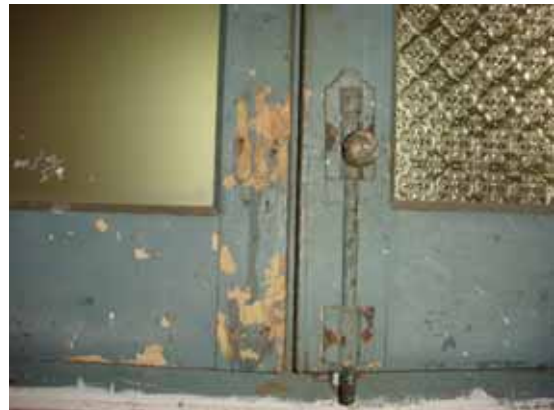
照片 6-21 五金生鏽、斷裂、佚失
