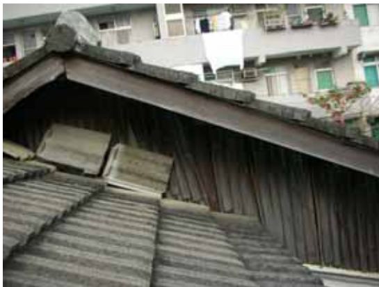
照片 6-11 高低屋頂接續處表面竹材歪斜脫落
