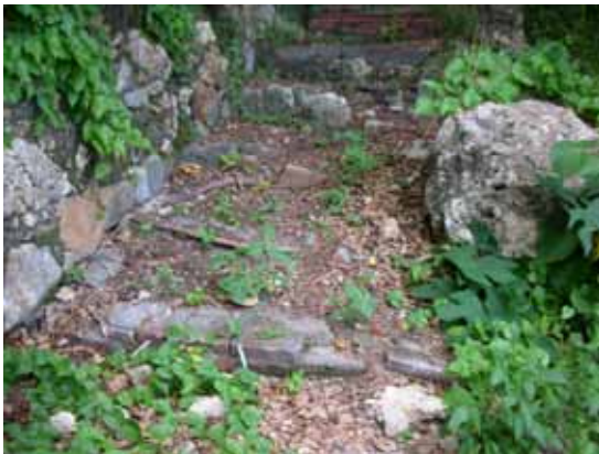
照片 4-106 階梯面遭巨石掉落砸毀
