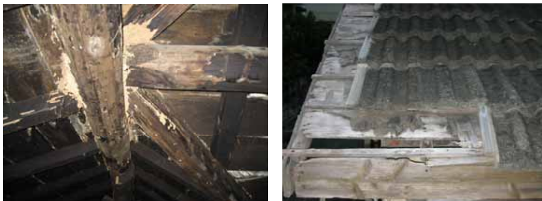
照片 6-29 木料風化損壞
