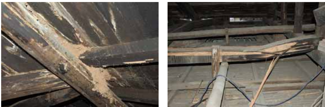
照片 6-28 屋架木料白蟻蛀蝕損壞
