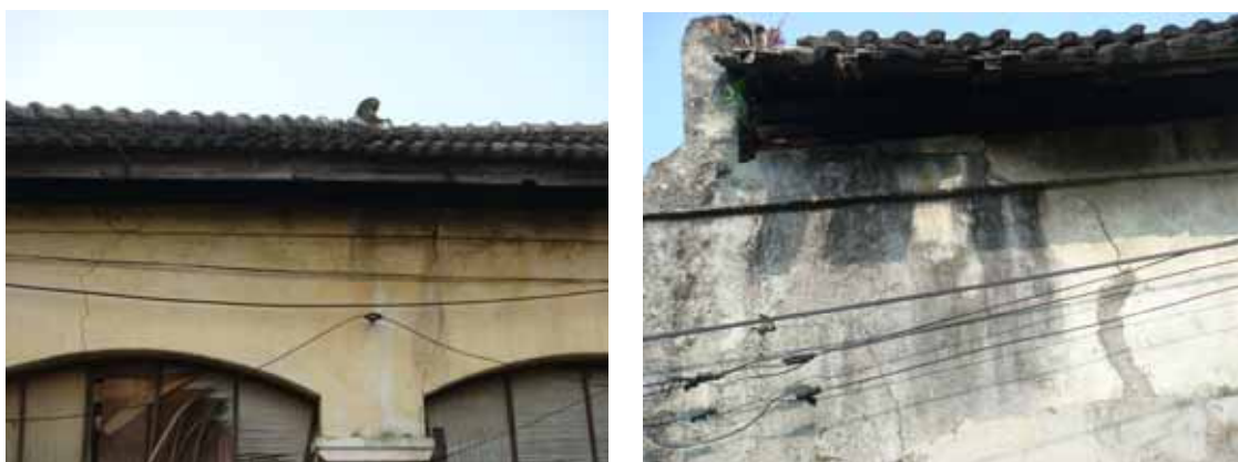
照片 6-45 迴廊外牆角隅磚拱上方斜向開裂
