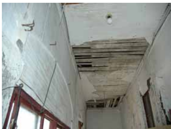
照片 6-22 木條灰泥剝落、木料腐朽
