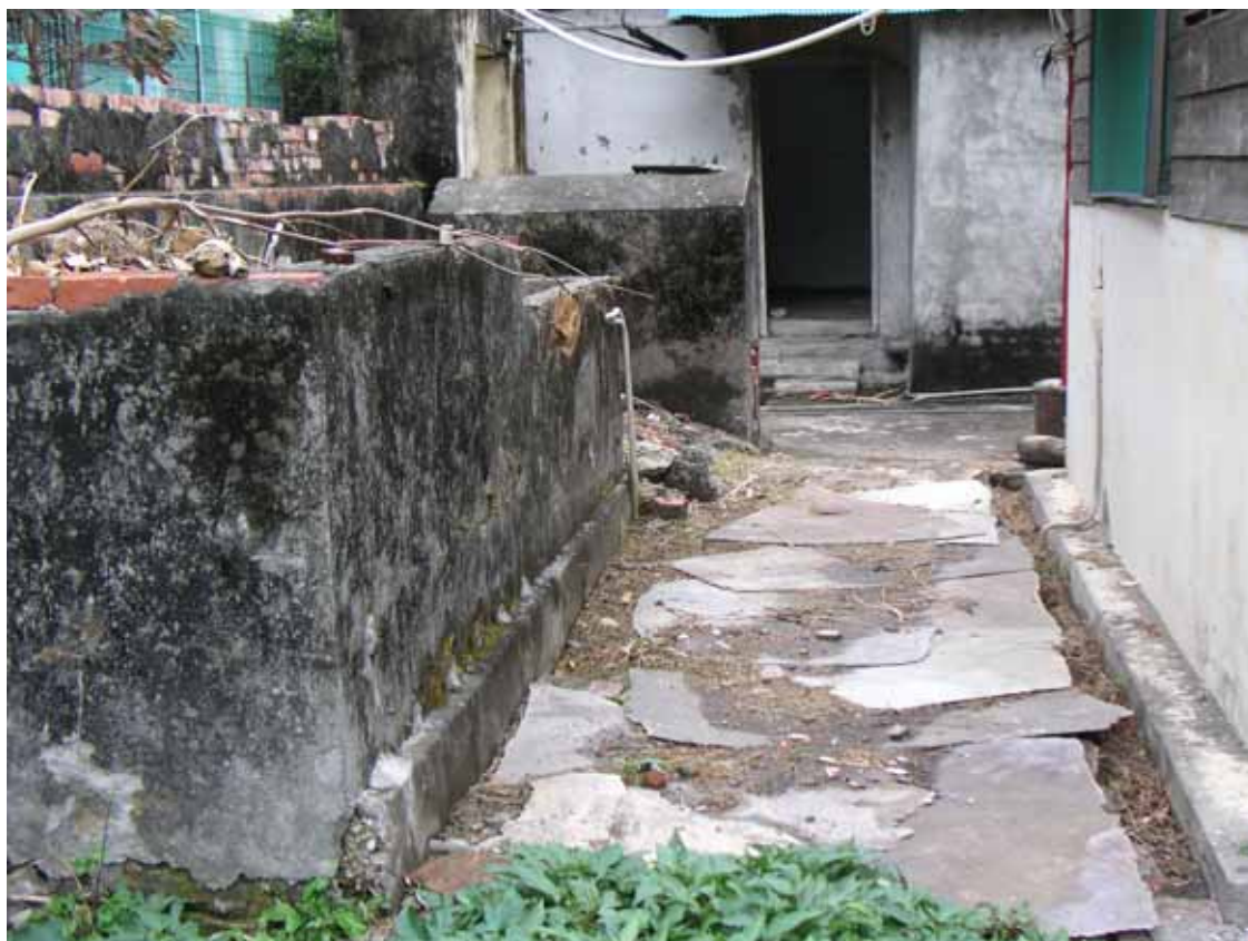
內院和式小屋左側焚化爐
