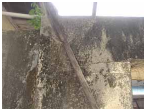
照片 6-10 東向立面磚造右門柱裂痕
