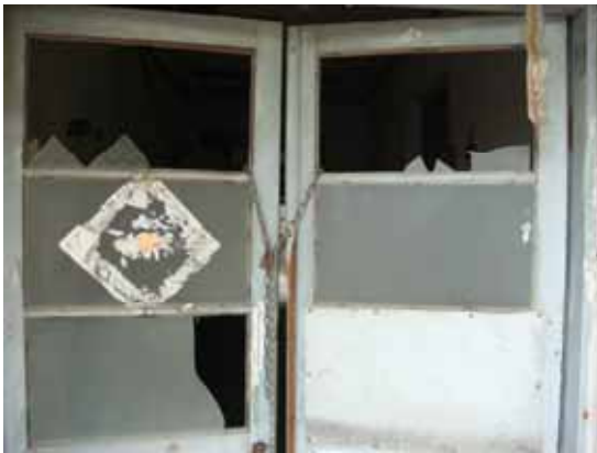
照片 6-15 門扇木料開裂及玻璃破損
