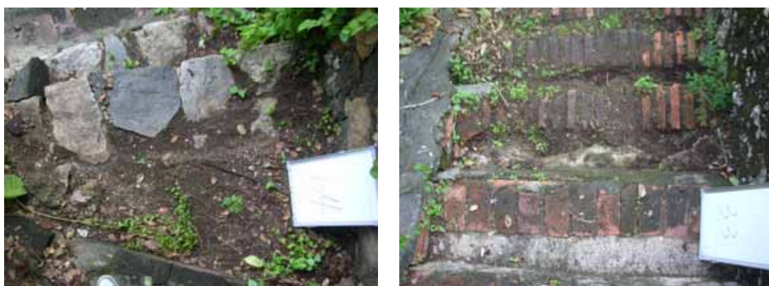
照片 6-40 階梯佚失
