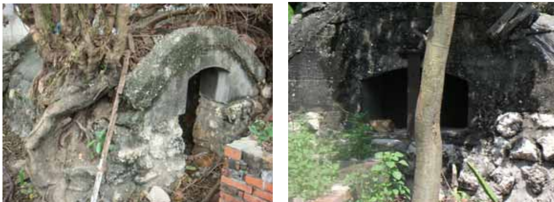
照片 6-38 防空洞損壞狀況
