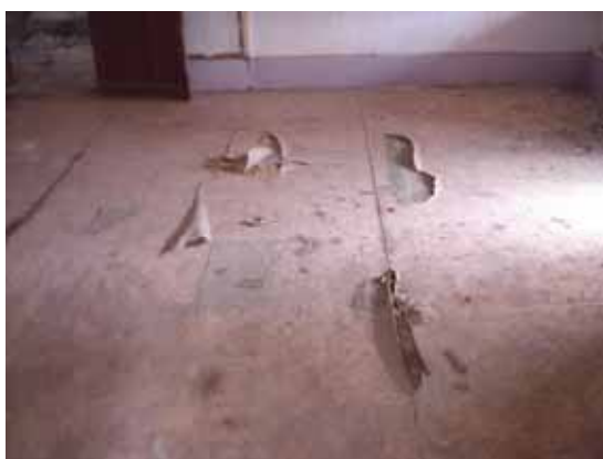
照片 6-6 塑膠地坪的脫膠翹起、撕裂破損損壞
