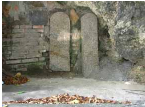
照片 6-34 基地東側靠登山古道處 圍牆殘跡
