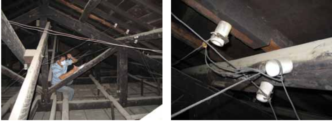
照片 4-87 屋架內的礙子及導線
