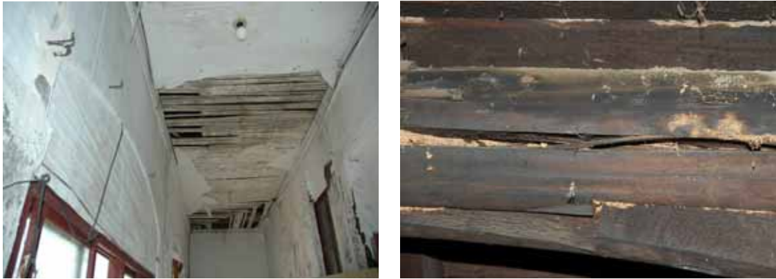
照片 6-27 屋架木料腐朽狀況
