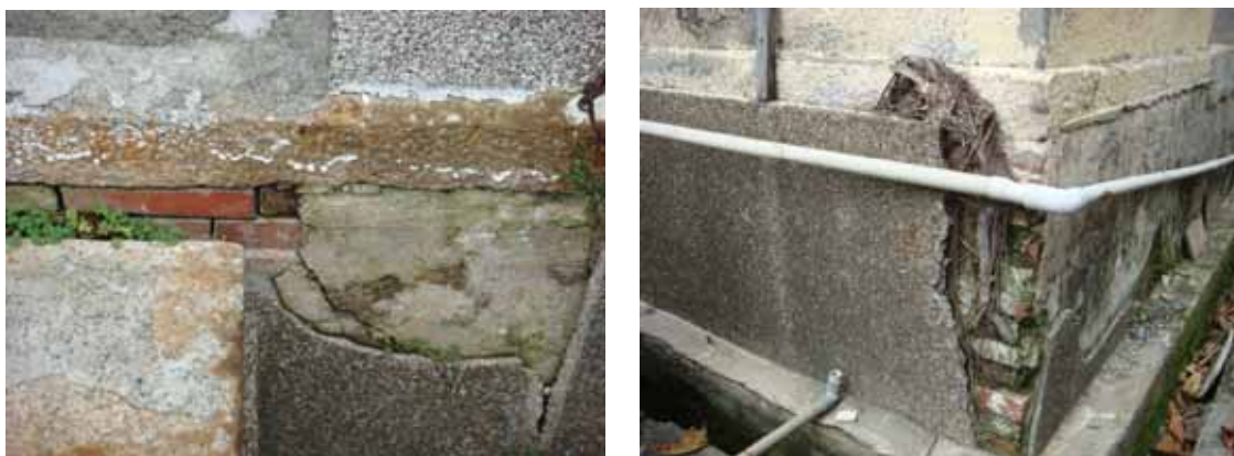
照片 6-3 基座剝落處磚面之產生青苔孳生、磚縫風化剝落的狀況
