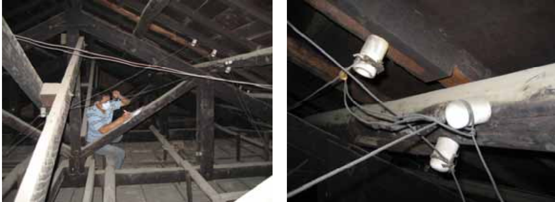
照片 4-87 屋架內的礙子及導線
