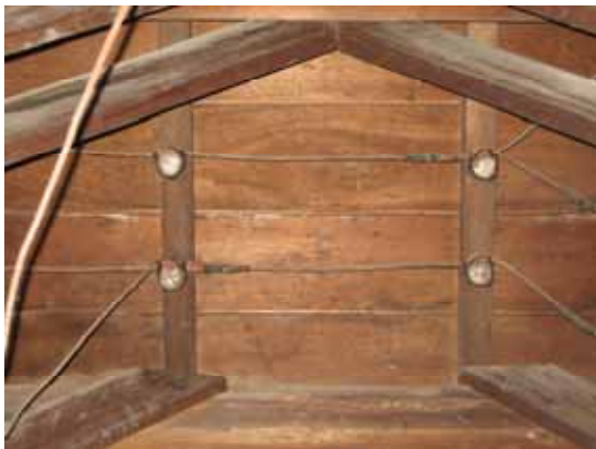
照片 4-88 和式小屋的礙子及導線
