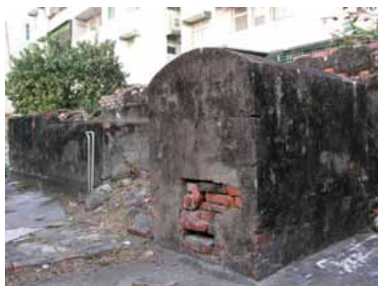
照片 4-13 內院焚化爐及儲水設備
