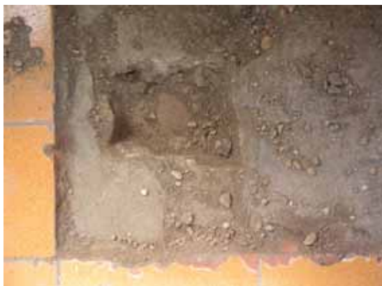
照片 3-3 瓷磚及下方水泥砂漿粉光
