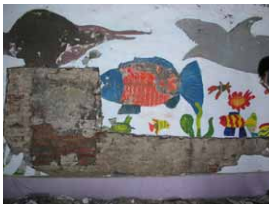
照片 3-26 牆面有一近似保險箱大小之開孔痕跡
