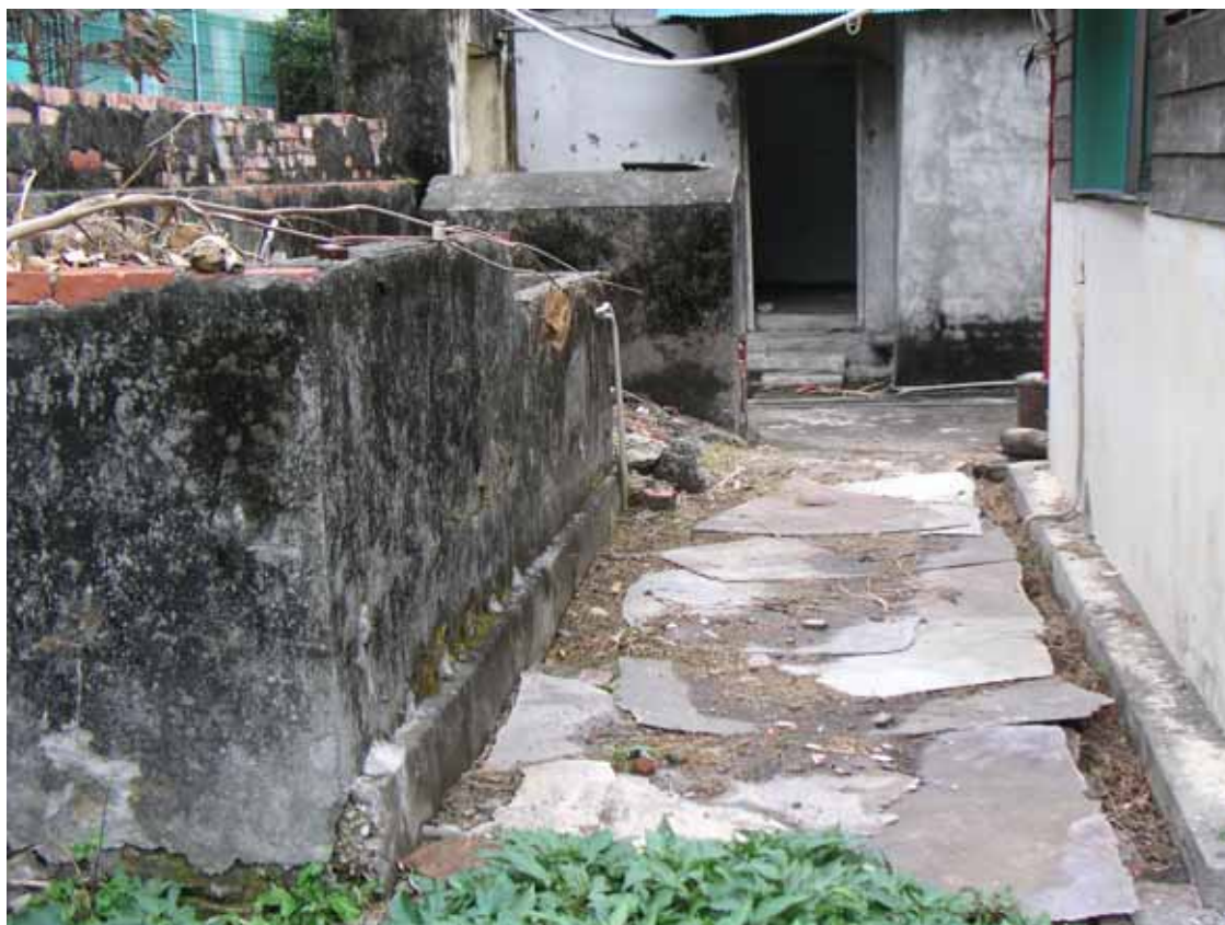
內院和式小屋左側焚化爐
