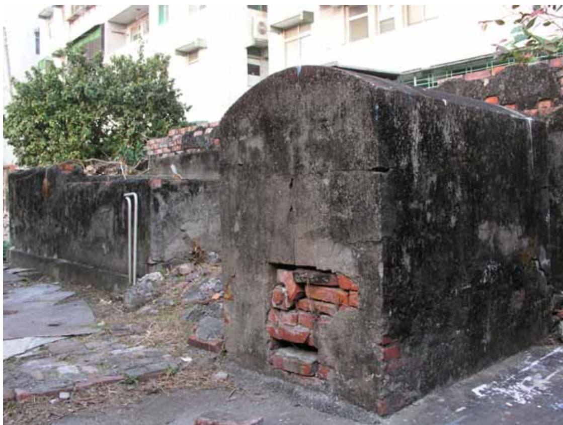
內院和式小屋左側焚化爐
